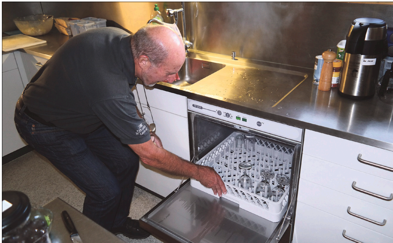
Dank der Stromversorgung hat das Hüttenpersonal nun auch einen Geschirrspüler: Baukommissionspräsident Robert Matter zeigt ihn.
