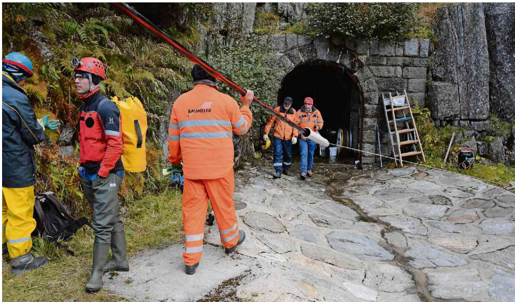
Auf der Urner Seite ist das Kabel gespannt, nun kann von der 4,5 Kilometer entfernten Tessiner Seite Zug kommen.
